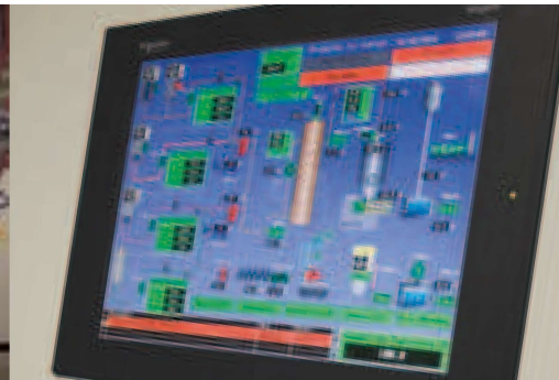
Pannello di controllo dell'impianto di saponificazione.
